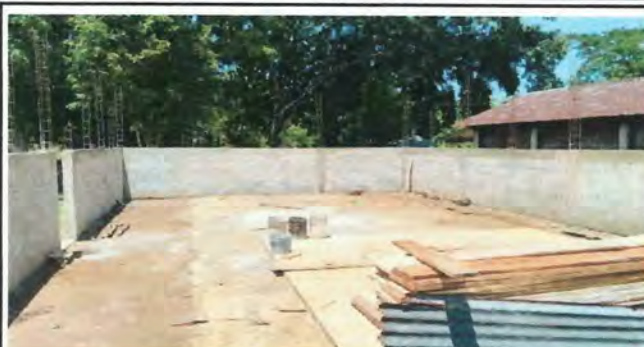
Foto 2: Se requiere de la fabricación e instalación de la estructura de techo y cubierta de lámina.
