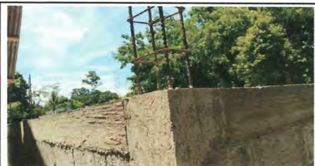
Foto 6: Se requiere de la instalación de una estructura y cubierta de techo para mantener un lugar seguro para la comunidad educativa y del mobiliario del centro educativo.
